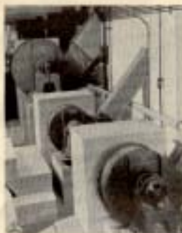
Fig. 12. Vista parcial de la serie de ventiladores para la ventilación de vitrinas.
