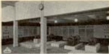
Fig. 6. Sala de máquinas.
