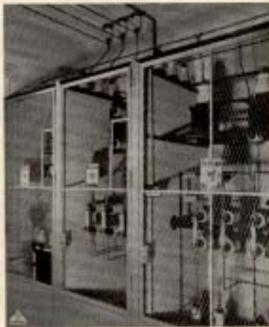
Fig. 3. Vista parcial de la celda de alta tensión.
